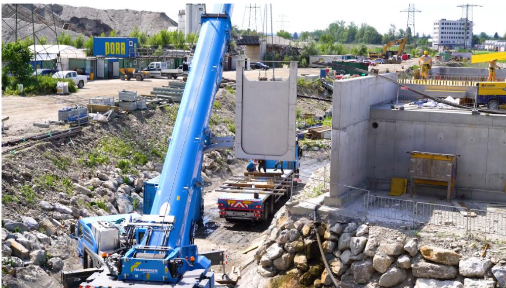
Für den Einbau des Hubwehres wurde ein Kran mit einer Traglast von 200 Tonnen verwendet.
